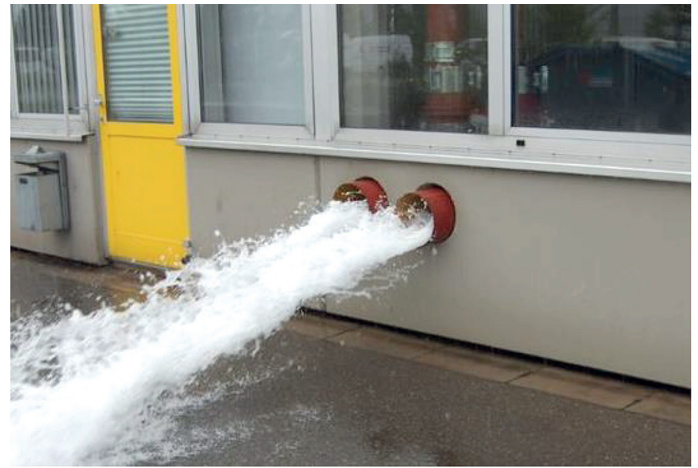
Notentwässerung eines großen Hallendaches während eines Starkregenereignisses (Bild: SAINT-GOBAIN PAM BUILDING)
