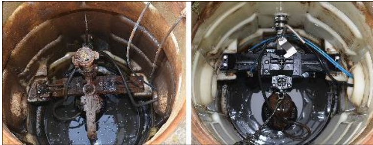
Bild 1: Sanierung des Schachtinnenlebens von Kunststoffschächten: Die korrodierten Armaturen wurden durch das Austauschset ersetzt, PKS-Schacht und MultiCut-Pumpe sind weiterhin im Einsatz. Bild: Pentair Jung Pumpen
