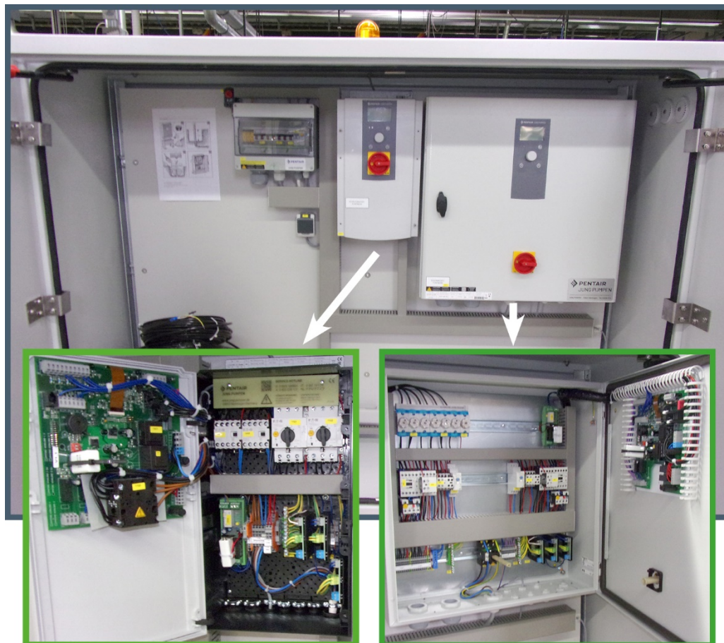
Bild 6 (Jung Pumpen GmbH): Die HighLogo-Mikroprozessorsteuerungen wurden individuell geplant und gefertigt und befinden sich für beide Pumpstationen in einem beheizbaren Außenschrank.
