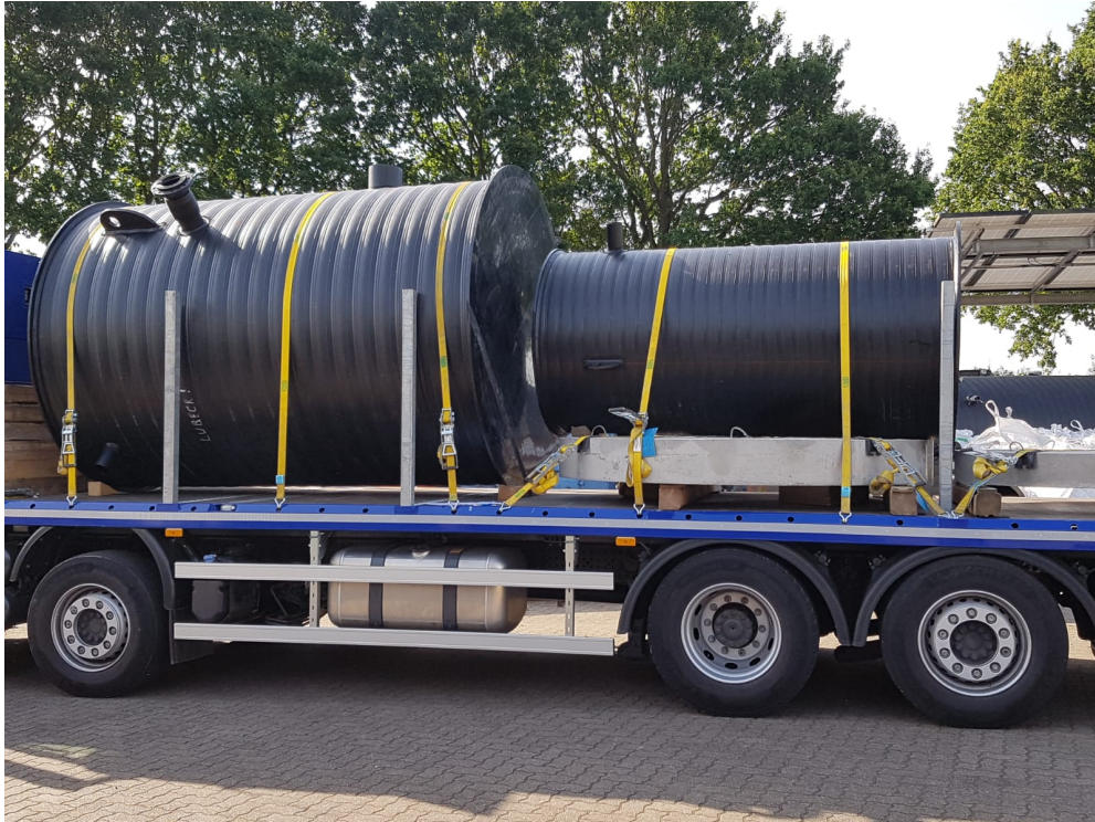
Bild 2 (Jung Pumpen GmbH): Lieferung der PKS-Kunststoffschächte und Abdeckplatten direkt auf die Baustelle
